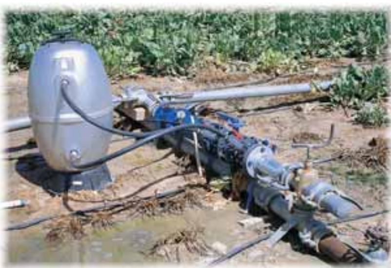
Estación de filtrado en una instalación de riego por goteo
