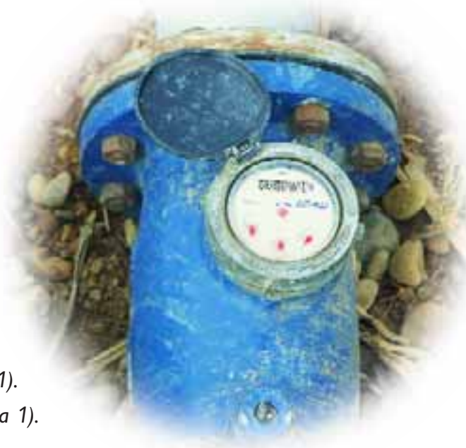
Medidor de caudal en tubería
