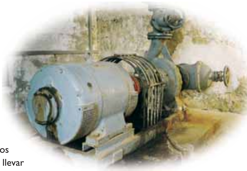
Grupo de bombeo
