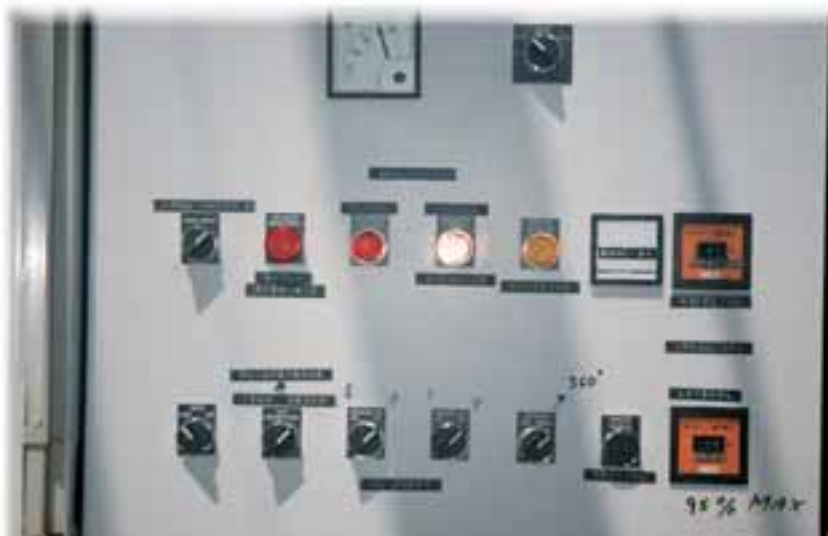
Cuadro de control eléctrico de automatismos
