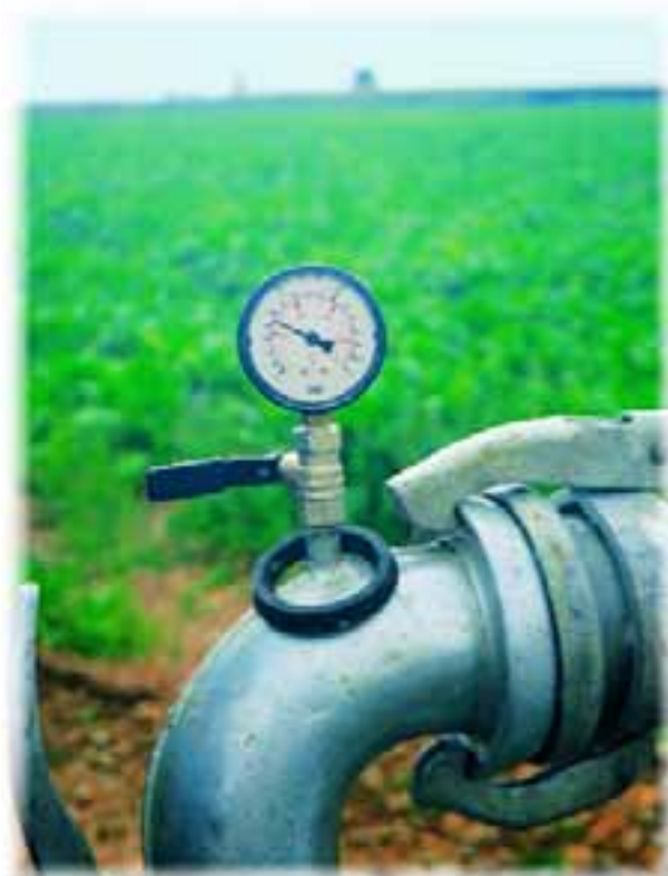
Manómetro en tubería principal
